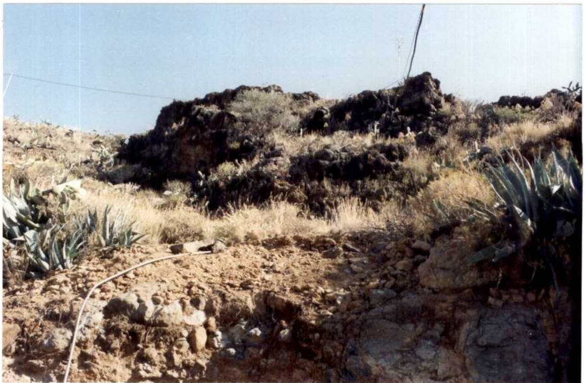
FOTOGRAFIA 5 : Vista del conjunto de bloques inestables de la zona I, realizada desde el camino de acceso a las viviendas afectadas.
