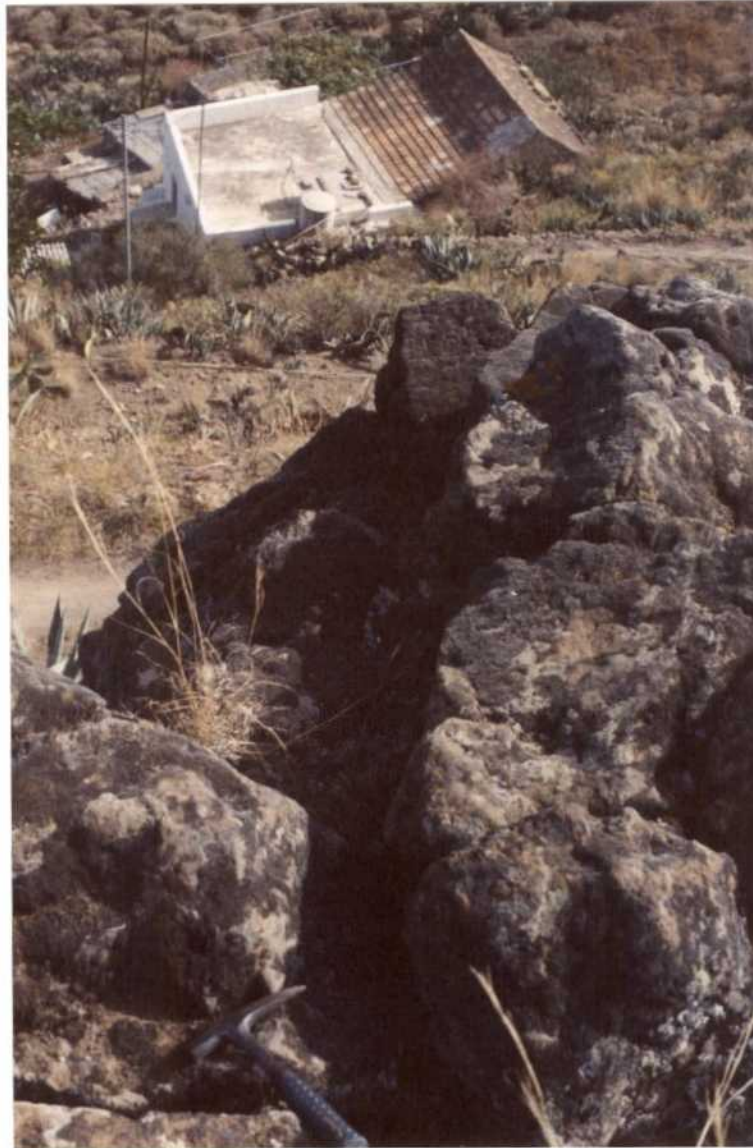
FOTOGRAFIA 8: Vista de las viviendas afectadas desde la coronación del escarpe del conjunto de bloques inestables de la zona II. Aparecen grietas y fracturas limpias y con una gran apertura, así como bloques que ya se han movido y/o girado y se encuentran en equilibrio inestable (como el de la fotografía 9).
